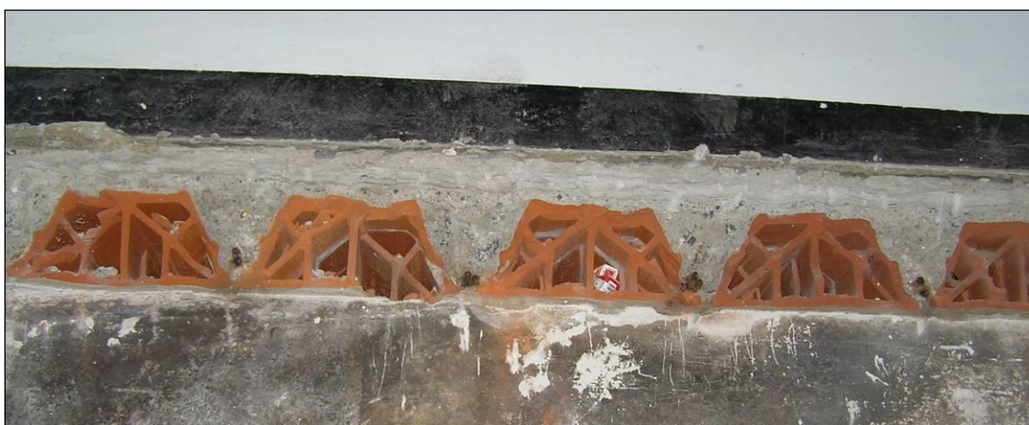
Reparación del forjado de un edificio de Coruña (1946), sin armadura de reparto
