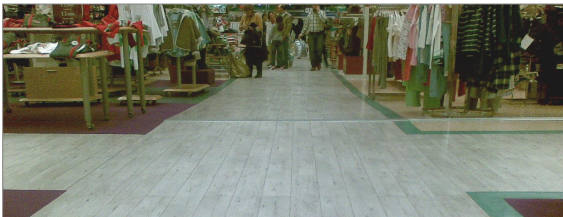
Deformación de la losa maciza en un centro comercial de Coruña (1982)
