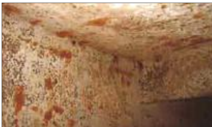
Sala situada en el sótano del antiguo Balneario de Lugo con signos visibles de agresión química sobre el cemento.
