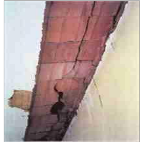
Fisuración en un forjado Ferrol (Coruña)
