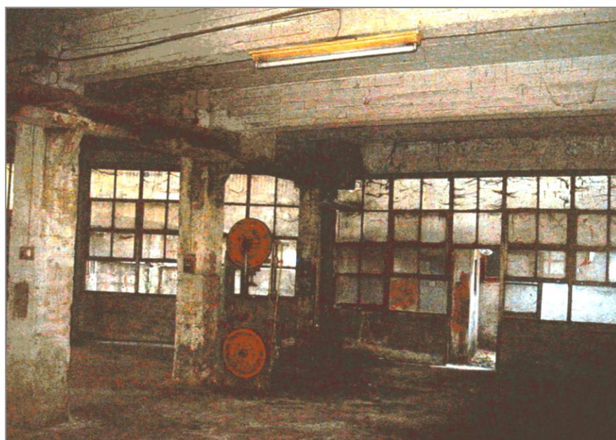
Edificio de viviendas en Coruña (1958): nótese tanto la relación entre el canto de las vigas y las luces empleadas como el pésimo estado de deterioro del material.
