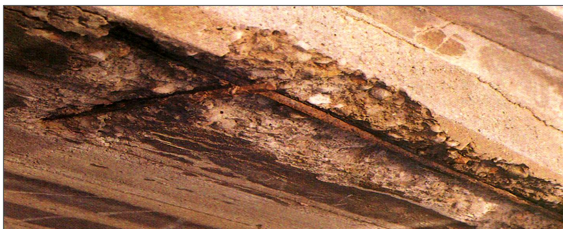
Carbonatación del hormigón por ataque químico, corrosión de las armaduras y posterior desprendimiento del recubrimiento (Marín – Pontevedra)
