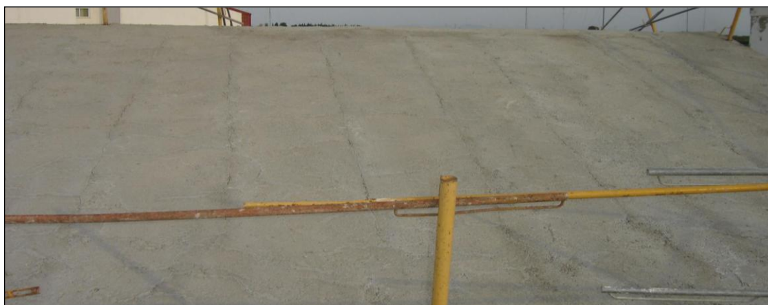
Fisuración de la losa superior por asentamiento plástico en Porriño (Pontevedra)
