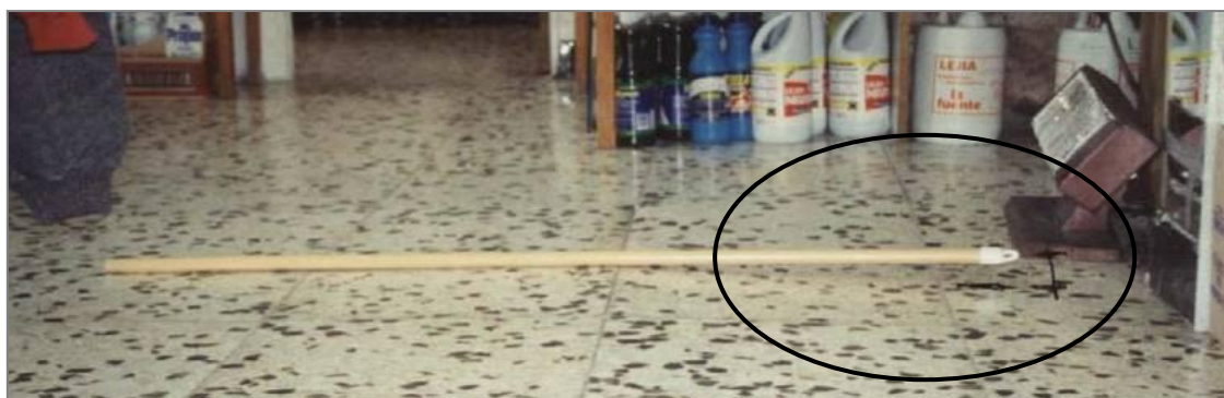
Forjado con un desnivel acusado por un asiento diferencial (Melide-Coruña)
