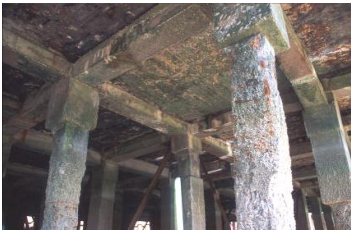
Efectos de la corrosión en ambiente marino sobre una estructura de hormigón
