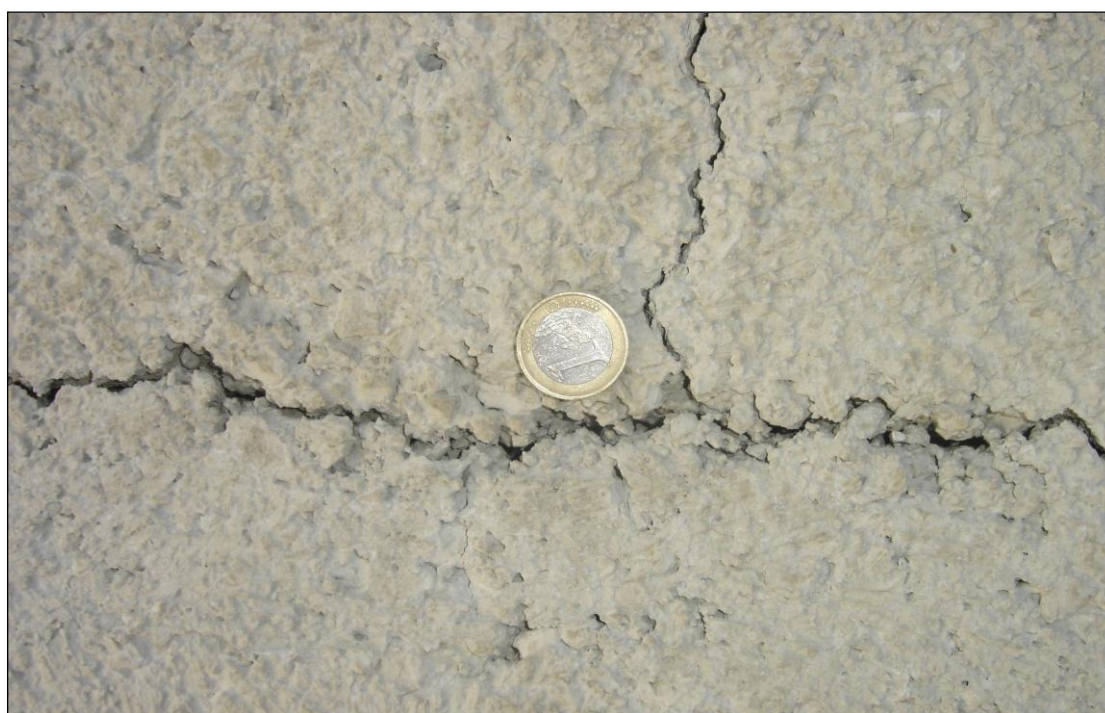
Fisuras por retracción plástica en una losa maciza en Verín (Orense)
