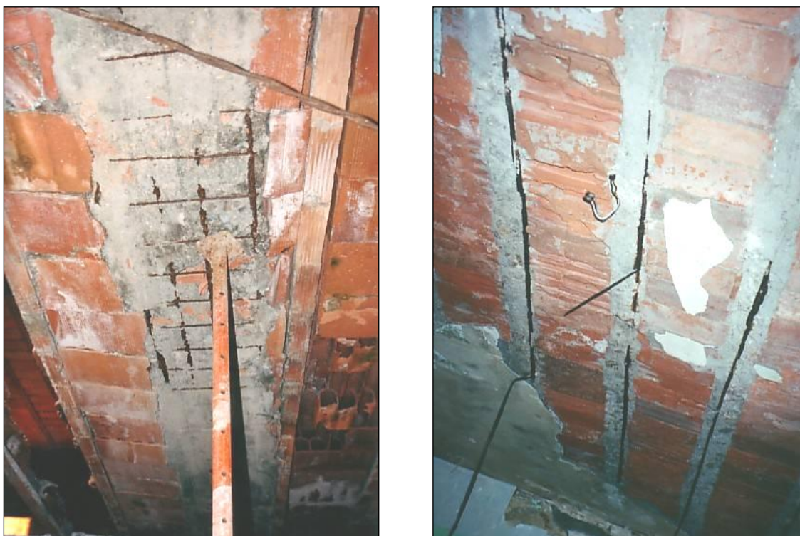
Casos graves de corrosión de armaduras de forjados en Orense y Lugo
