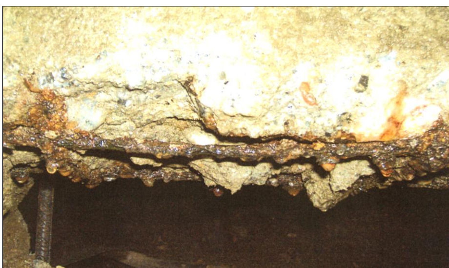
Aspecto de la cara inferior de una riostra de cimentación en contacto con el terreno de un edificio de Coruña de 1943.
