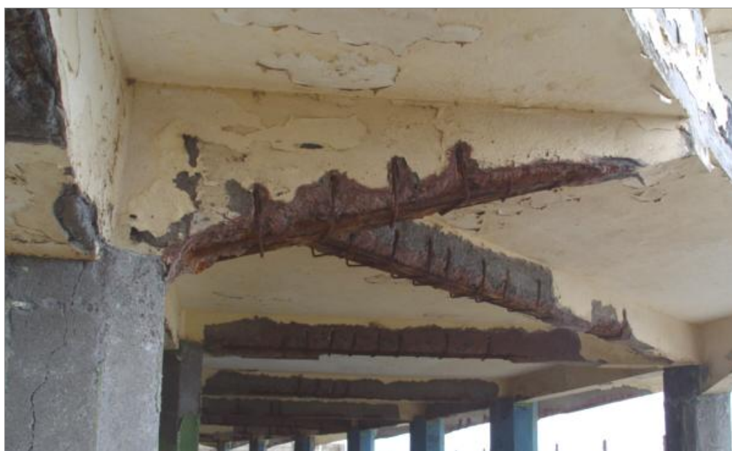
Corrosión metálica en vigas expuestas a la acción agresiva del medio marino
