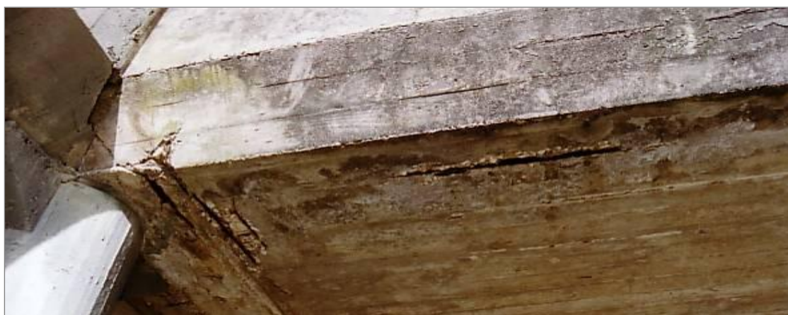
Sales de carbonato cálcico en un forjado expuesto Barrio de Esteiro en Ferrol (Coruña)
