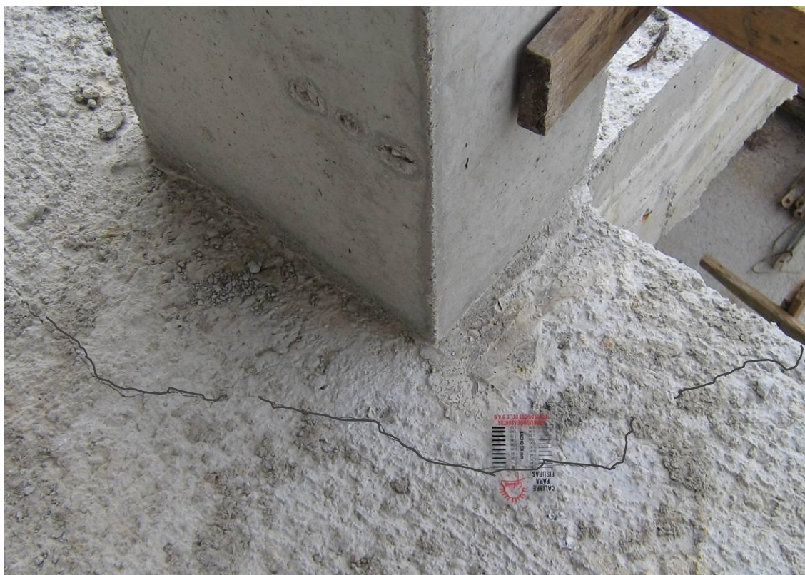
Rotura del forjado en torno al pilar por un asiento diferencial (Moaña-Pontevedra)
