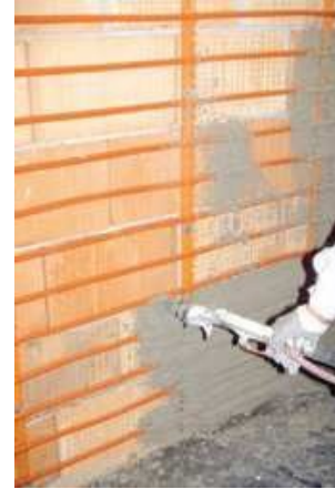
Sistema de calefacción por muro radiante, embebido en el mortero de revestimiento.
