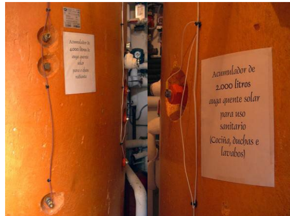
Depósitos de acumulación del agua caliente solar para uso sanitario y calefacción por suelo radiante.
