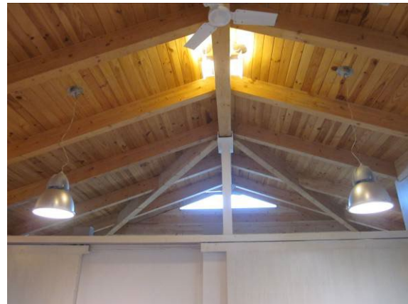
Estructura de la cubierta en madera laminada. Lámparas de bajo consumo. Ventilador para controlar la temperatura en verano (consumo inferior al de un sistema de aire acondicionado)
