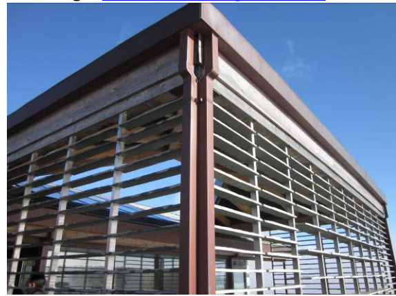
Sistema de protección solar delante del invernadero. Las dimensiones y separación entre las lamas permiten el paso del sol en invierno y lo impide en verano.
