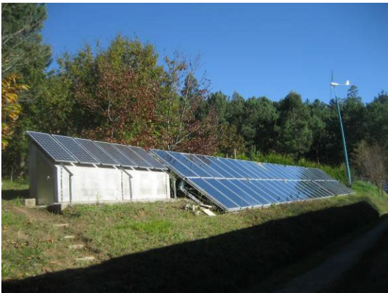
Instalaciones de energía eólica y solar (térmica y fotovoltaica)
