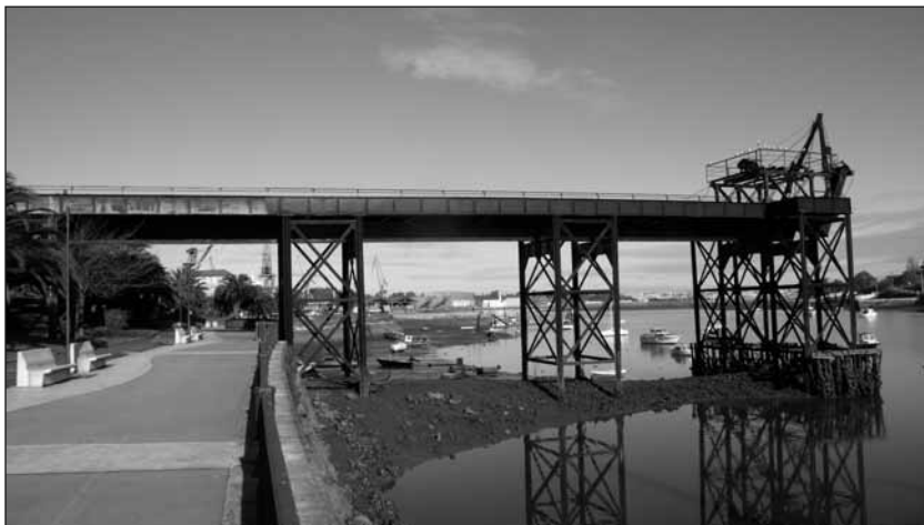
Embarcadero de la Orconera, transformado por el paso de la Autovía del Cantábrico. C. N.
