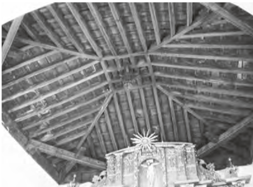
Figura 1 Uso de las limas simples en la cabecera de la iglesia de Lamalonga, A Veiga, Ourense (imagen del autor)
