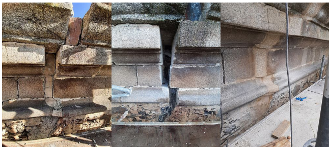
Figura 6. Fases de la reparación de la cornisa exterior: estado inicial, picado y completado.
