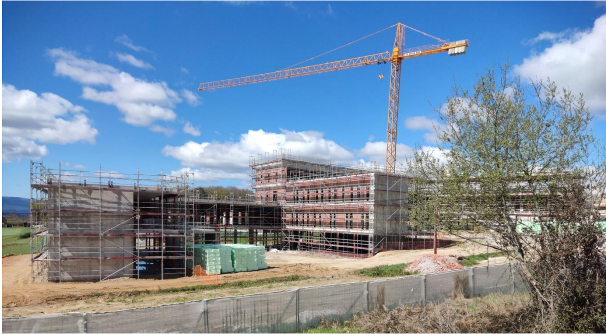
Imagen 36: Avances en la ejecución de la estructura C.I.S. Fachada Noreste Fuente: Propia
