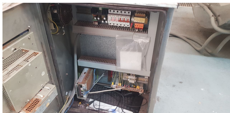
(c) Detalle do interior do armario de pesaxe
