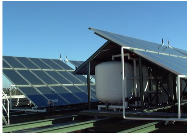
Figura 1: Planta de climatización solar localizada en la Escuela Técnica Superior de Ingeniería de Sevilla.
