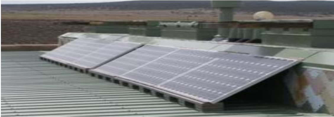
Figura 37. Ejemplo de instalación de los paneles solares (Fuente: Frontlinecopy).
