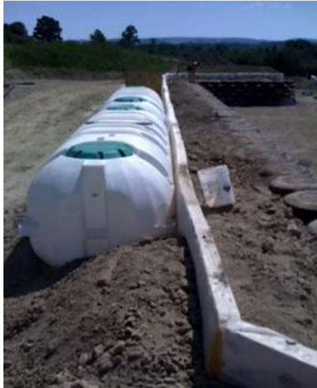
Figura 41. Sistema de cisternas para recolección de agua con su debido aislamiento.
