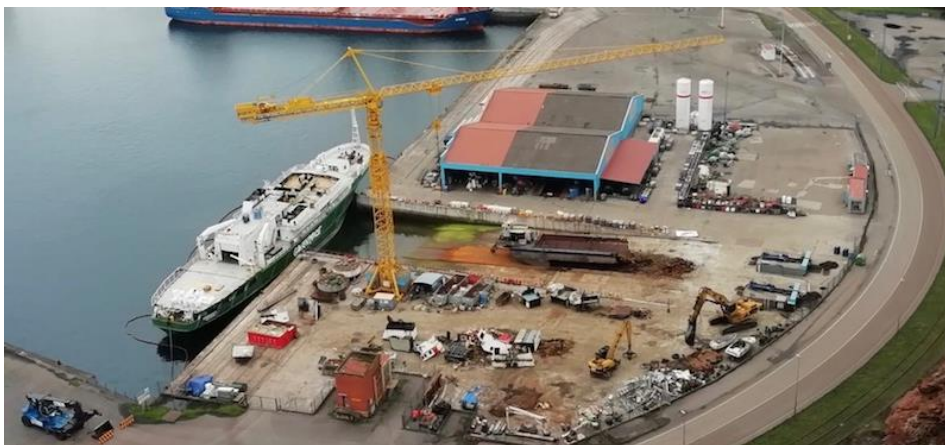
Figura 5.2.6. Panorámica de las instalaciones de DDR VESSELS XXI, SL (LORENZO, 2022)
