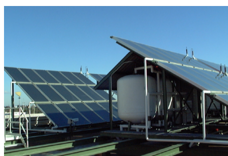
Figura 2: Instalación de climatización solar.
