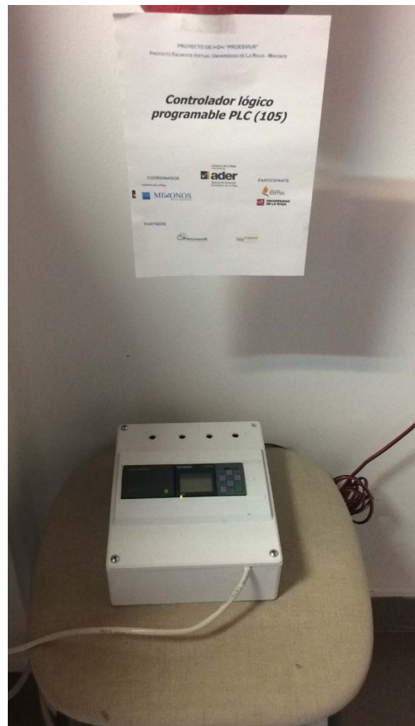
Figura 6: Detalle montaje PLC (105)
