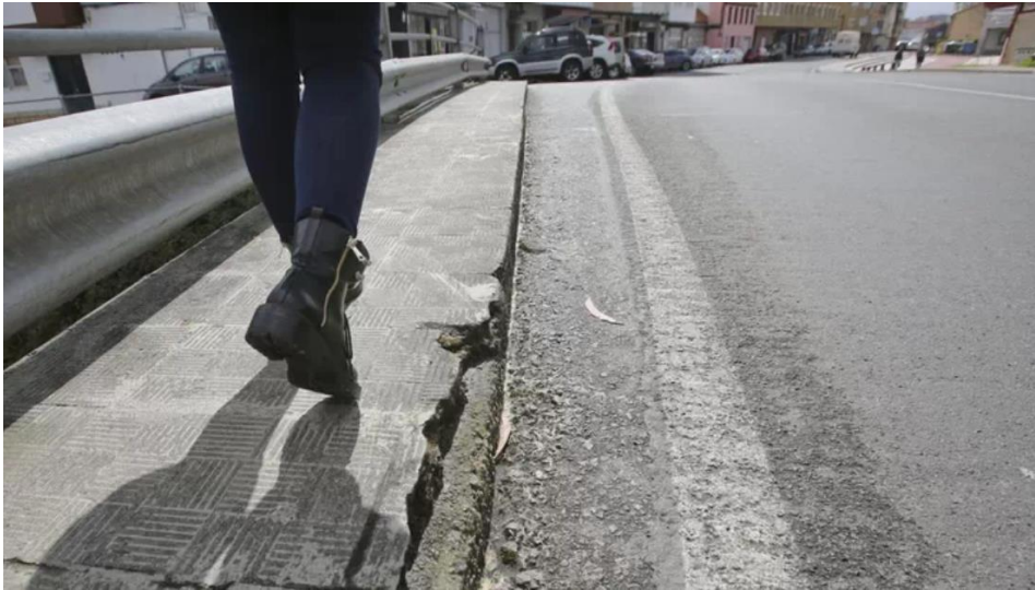
Figura 7.- Estrechez de las aceras del puente situado sobre la vía del tren en Santa Icíá, Narón
