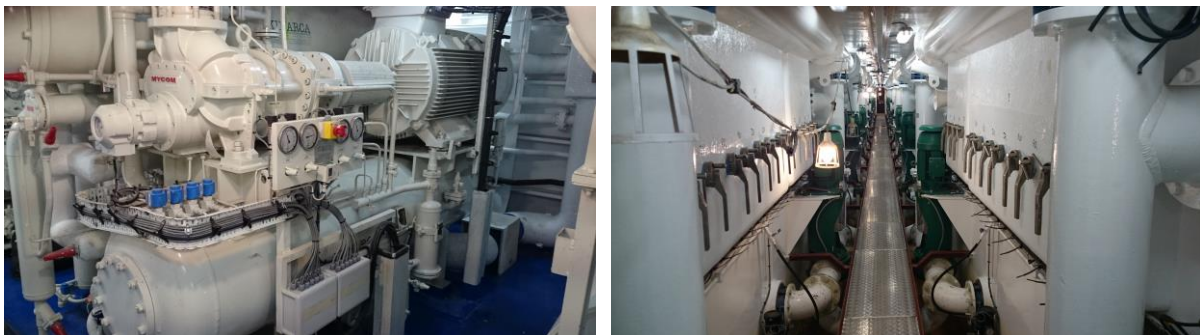
Figura 73. Compresores del sistema de refrigeración (izquierda) y túnel de congelación (derecha).
