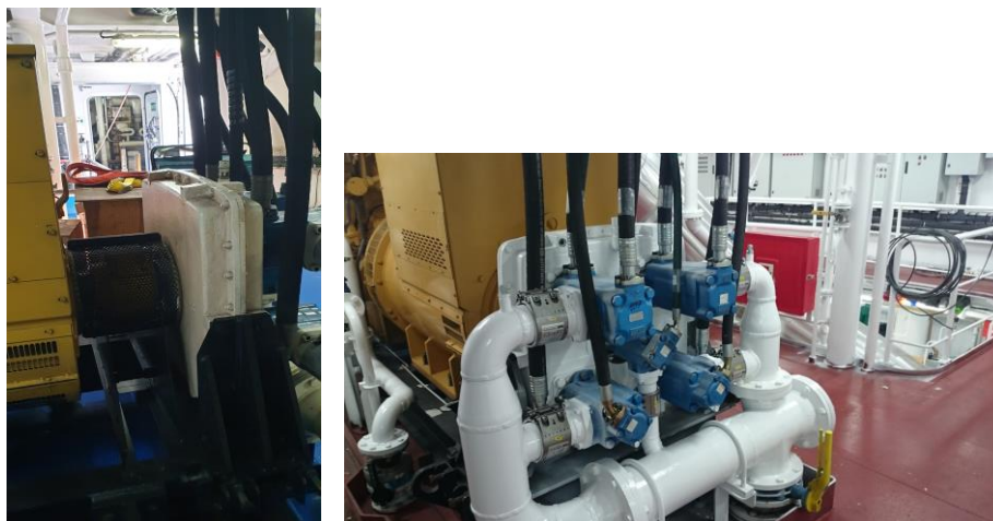
Figura 78. Toma-fuerza y bombas hidráulicas acopladas al toma-fuerza.
