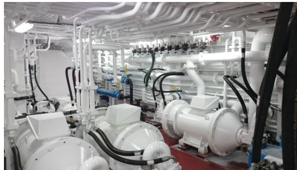
Figura 79. Motores eléctricos y bombas hidráulicas del sistema hidráulico.
