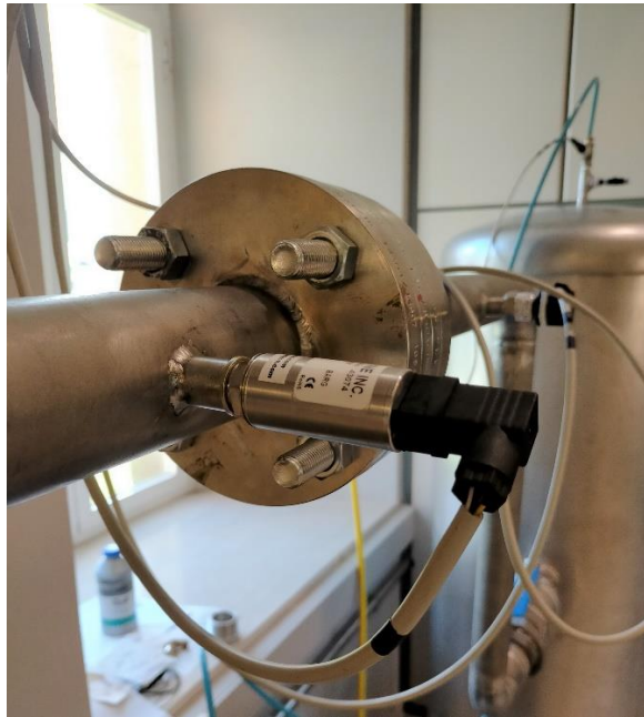
Figura 72 Transductor de presión estática estacionario aguas arriba de la placa de orificio.
