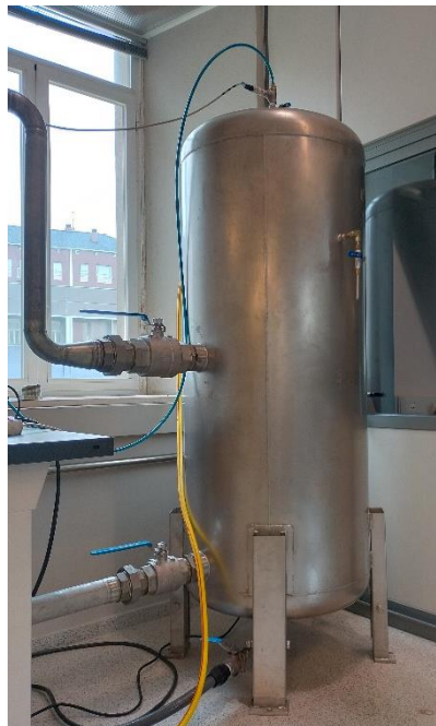
Figura 57 Depósito de 700 L.
