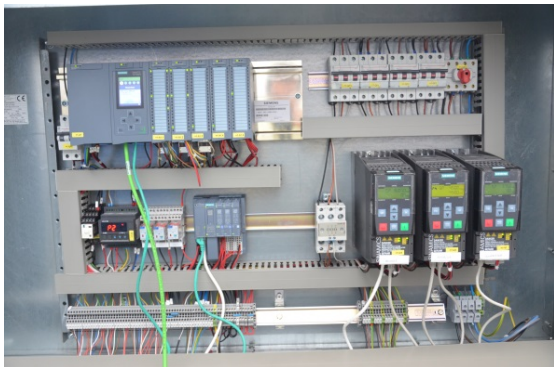
Figura 6: Cuadro eléctrico del prototipo
