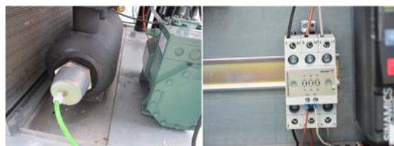
Figura 4: Resistencia calefactora insertada en el depósito de glicol y su regulador trifásico
