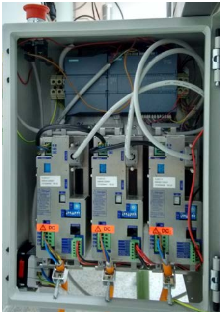
Figura 8: Armario de control del robot cartesiano.
