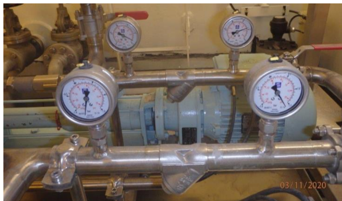
Figura 6.4.1 - Manómetros locales bombeo urea fuera rango
