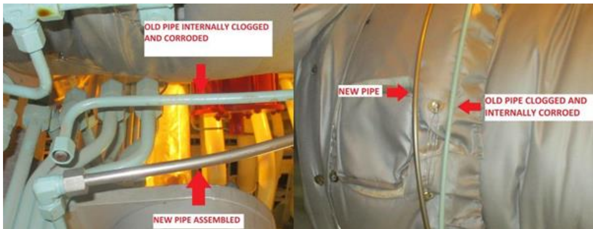
Figura 6.1.2 - Tuberías instaladas mismo diámetro
