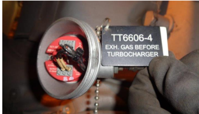
Figura 6.3.2 - Cambio del sensor de temperatura entrada gases al T/C
