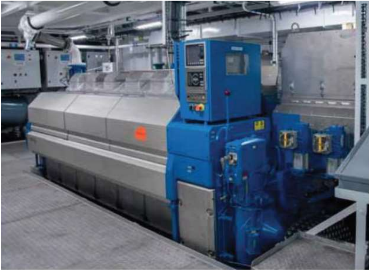
Ilustración 6: motor Wärtsilä 6L32 instalado en la cámara de máquinas de un pesquero
