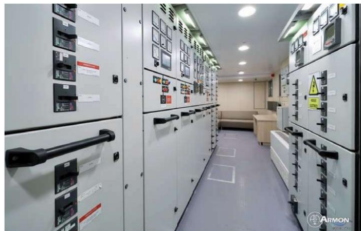
> Galería de cuadros eléctricos.
