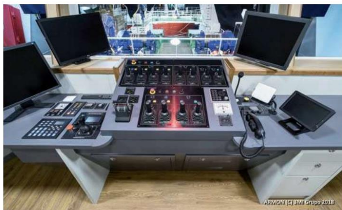
► Puesto de control de maquinaria de pesca instalado a popa del puente.
