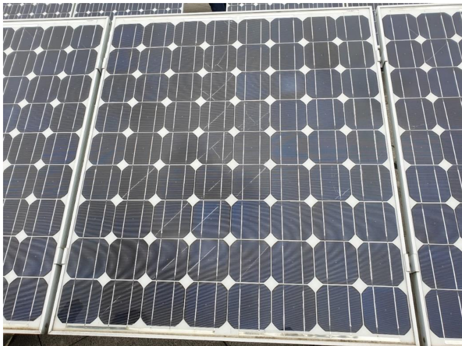
Figura 58 Imagen de los módulos del sistema fotovoltaico CITIC
