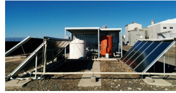
Figura 1: Instalación piloto SMD en la PSA.
