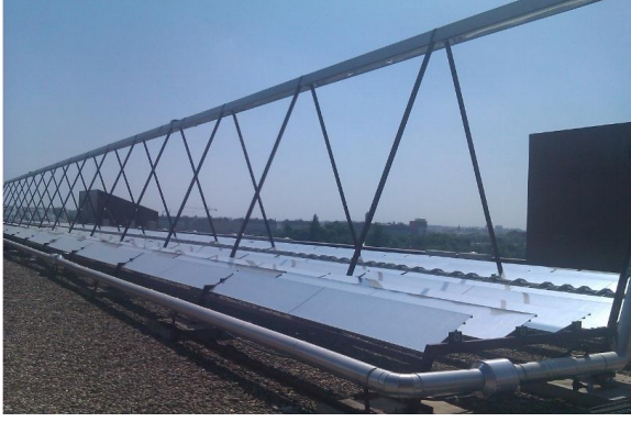
Figura 1: Campo de colectores Fresnel
