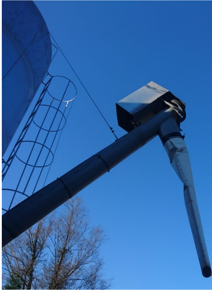
Figura 4.2.4.1 – Motor del silo de pienso
