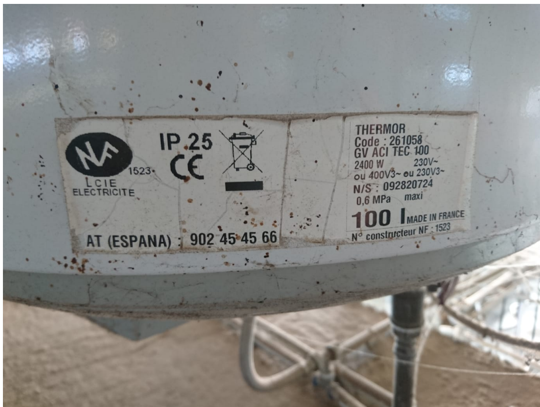
Figura 4.2.2.1 – Termo eléctrico de la explotación
