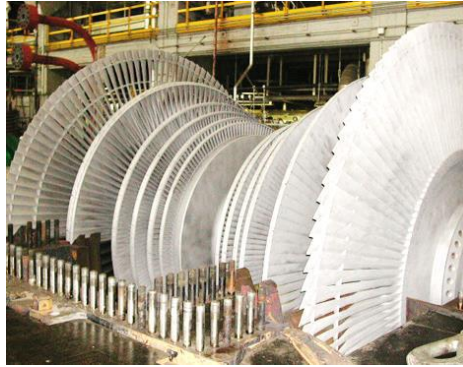
Figura 22. Detalle del cuerpo de la turbina de baja presión.
