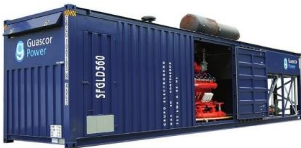
Figura 10.3.1.1 - Vista del exterior del contenedor del generador Fuente: EINESA Ingeniería (2017) [40]
