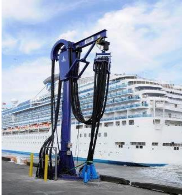
Figura 7.4.5- Cables de conexión Shore-To-Ship en el muelle Fuente: Cavotec (2009) [20]
