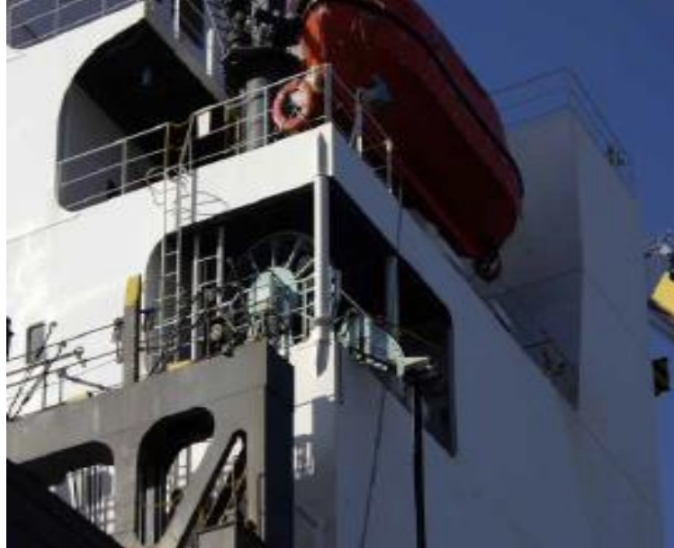
Figura 7.4.2 - Conexión Shore-To-Ship integrada en buque Fuente: García, F. [21]
