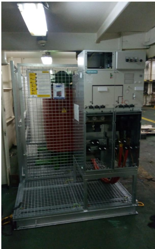
Figura 7.4.6 - Transformador para conexión Shore-To-Ship en el buque Fuente: Propia del Autor
