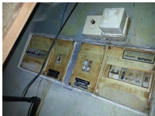
IMAGEN 16: Cuadros eléctricos (Fuente: elaboración propia)
