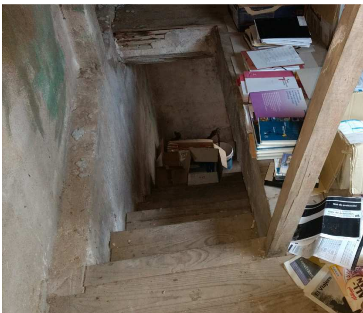
IMAGEN 13: Escalera de madera que da acceso a la planta bajo cubierta (Fuente: elaboración propia)
