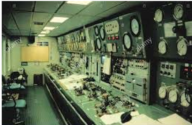
Figura 2.3.6. Sala de control de un complejo de saturación. Fuente: Alamy.
