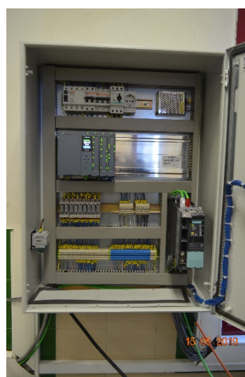
Figura 16: Vista del interior del nuevo armario de control ya colocado en posición
