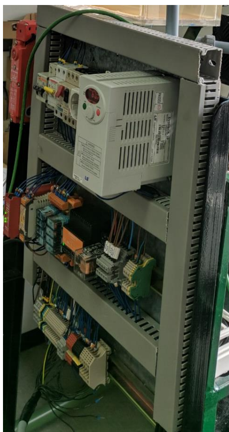
Figura 2: Armario de potencia del demostrador.
