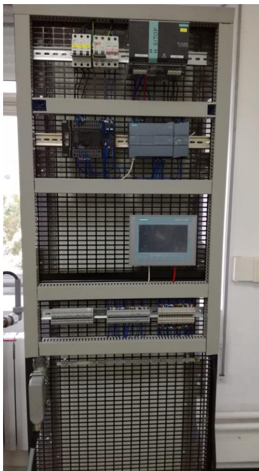
Figura 6: Armario de Control de Planta
