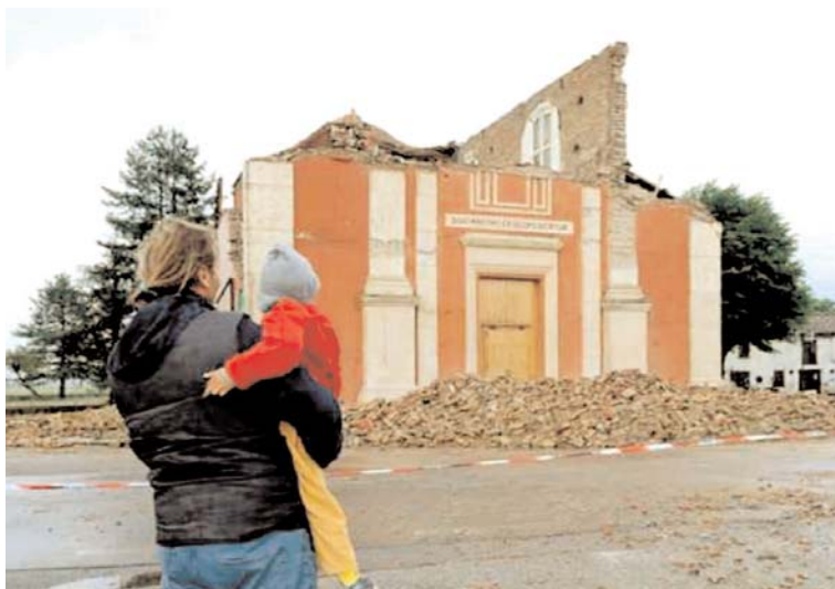
Fig. 01. Los daños del terremoto de 2012 en el patrimonio eclesialístico de Emilia Romagna.
