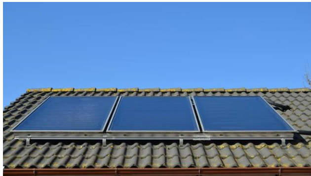
Figura 5. Panel fotovoltaico. Fuente: www.tesa.com
