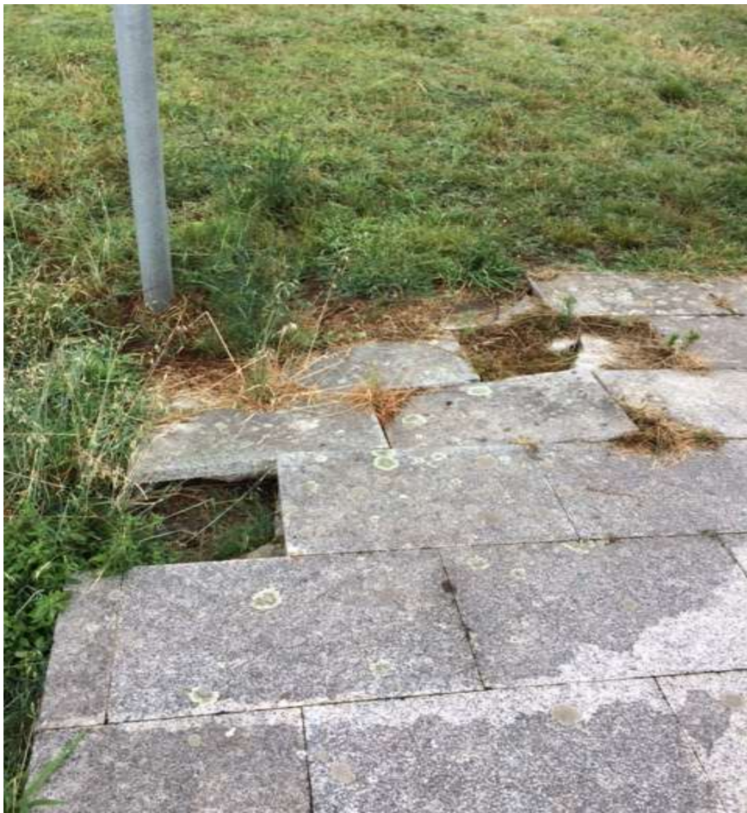
Imagen nº21: Estado actual de la solera de la pérgola.
