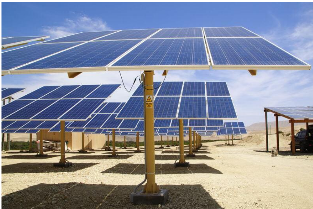
Figura 24: Estructura soporte tipo Tracking con seguidor solar
