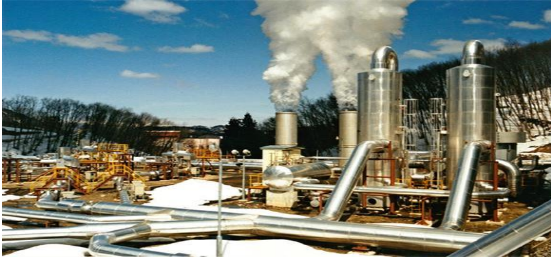
Figura 9: Central geotérmica de Yanaizu, prefectura de Fukushima, Japón.
