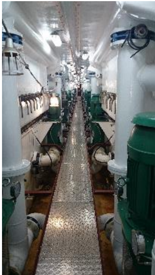
Imagen 65. Túnel de refrigeración
