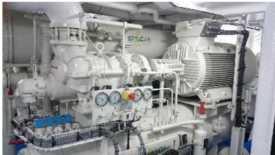
Imagen 64. Equipo de refrigeración
