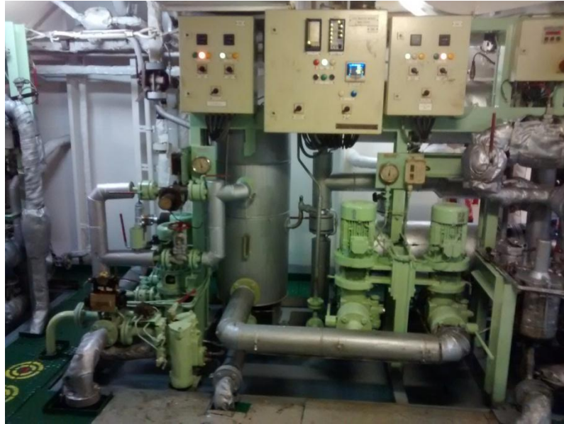
Figura 6.4.5.2.3.1 - Unidad preparación combustible auxiliares [39]
