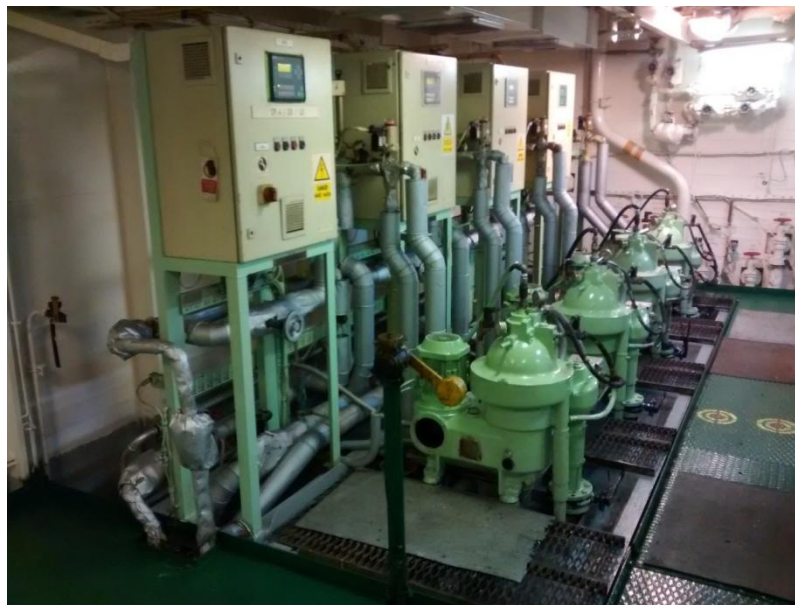
Figura 6.4.5.2.3.2 - Depuradoras de gasóleo y aceite [40]
