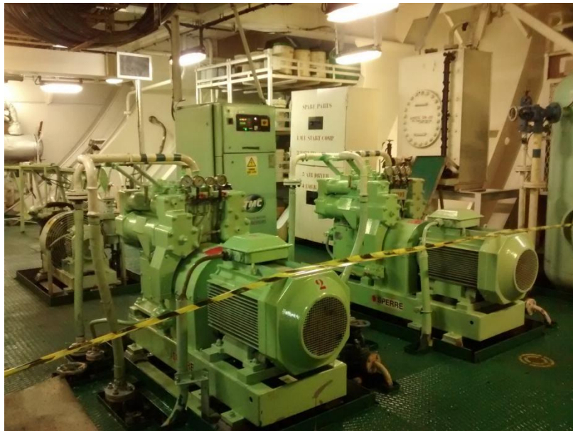
Figura 6.4.4.2.8.1 - Compresores arranque motor principal [42]
