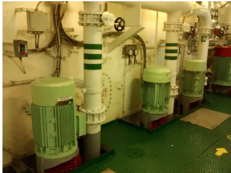
Figura 6.4.5.2.6.1 - Bombas de agua salada [41]
