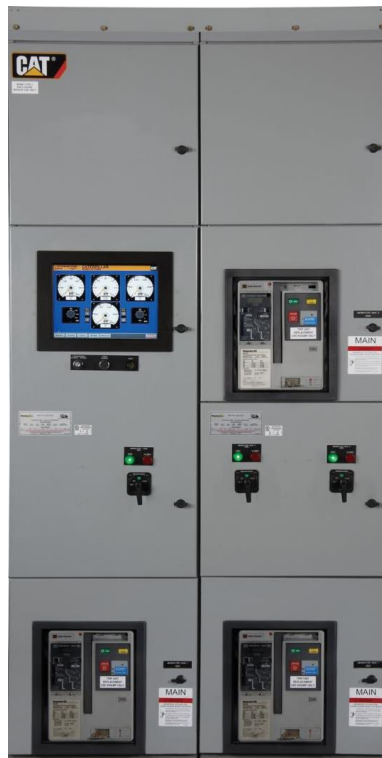
Figura 4.2 – Cuadro eléctrico de emergencia
