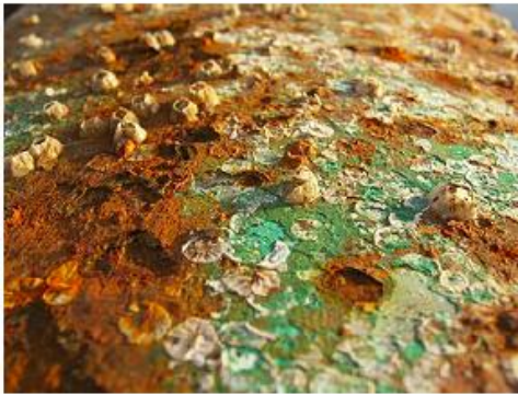
Corrosión de un metal
