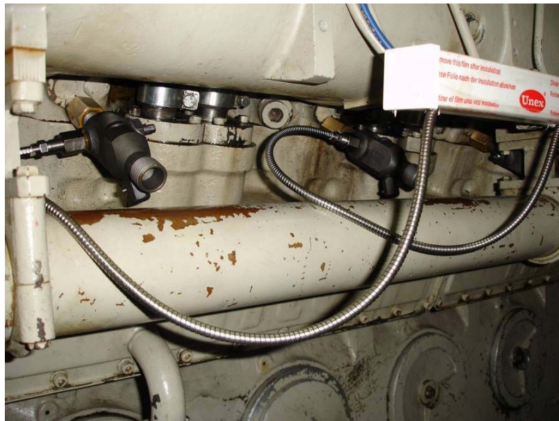
Foto 3. Detalle de instalación de los sensores en el motor.
