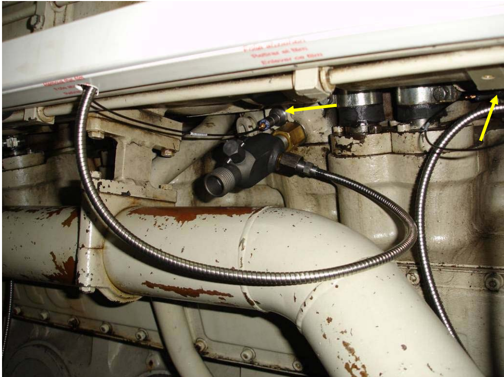
Foto 6. Colocación de los acelerómetros en el motor que se monitoriza.
