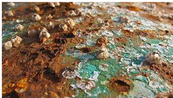
Ilustración 13-Corrosión biológica general
