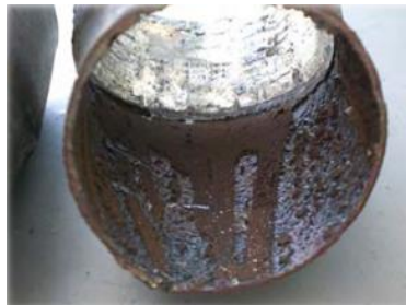
Ilustración 16-Corrosión por erosión
