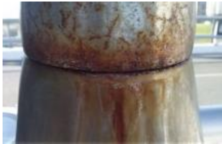
Ilustración 18-Corrosión en resquicios
