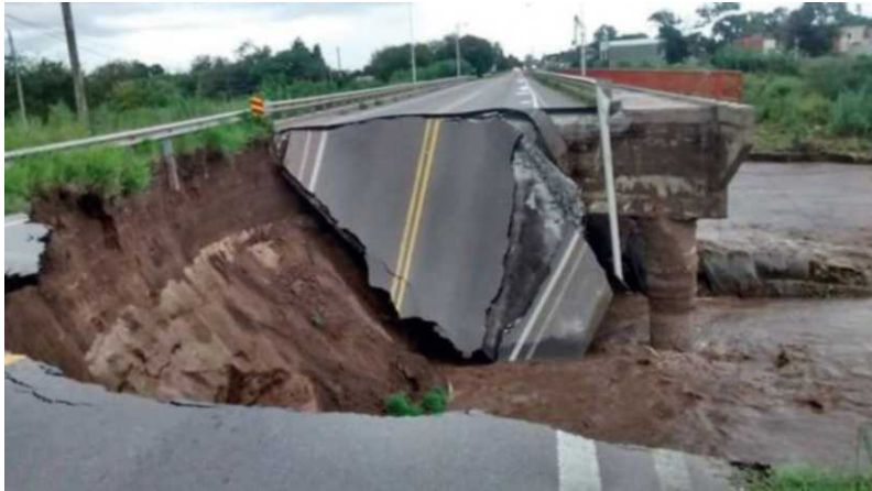
Figura 8. Corte en la Provincia de Córdoba. Colapso de puentes.
