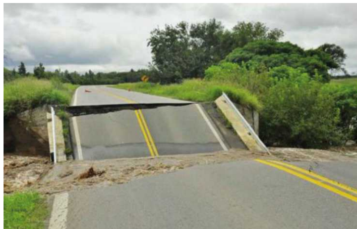
Figura 9. Rotura de puente en Totoral. Provincia de Córdoba
