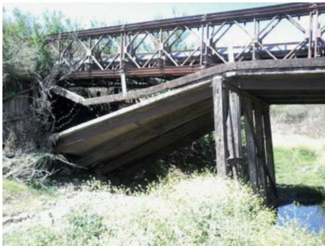
Figura 4. Descalce de la cabecera del puente en camino vecinal.
