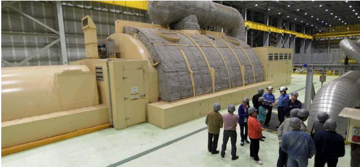
Ilustración 6: Turbina de vapor de la CTCC de As Pontes
