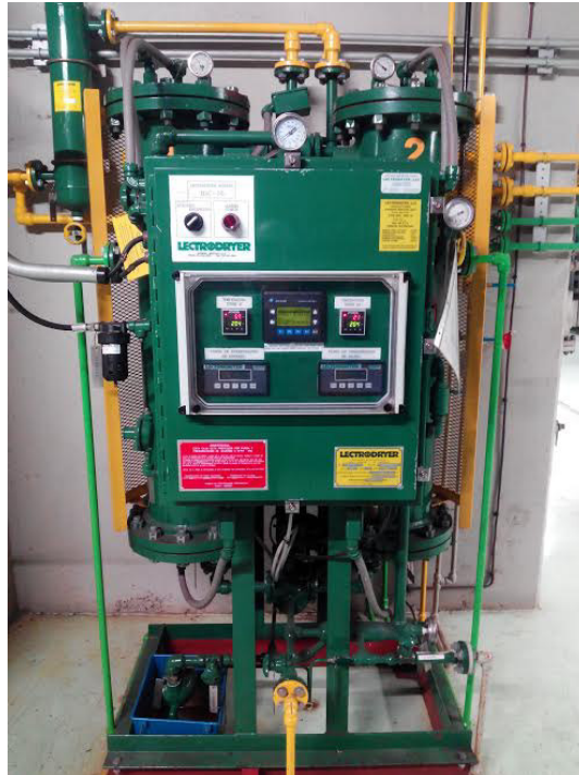
Ilustración 10: Secador de hidrógeno. LECTRODRYER BAC-50
