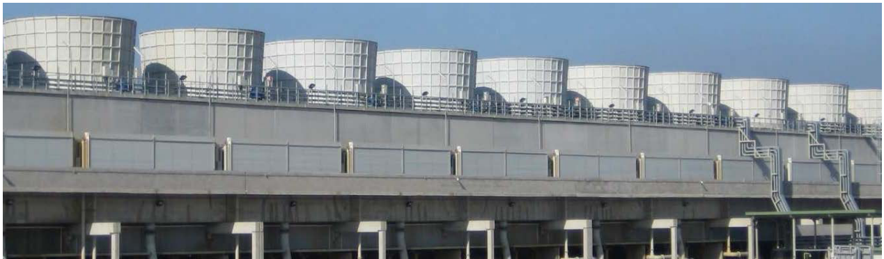
Ilustración 8: Torres de refrigeración de la CTCC de As Pontes
