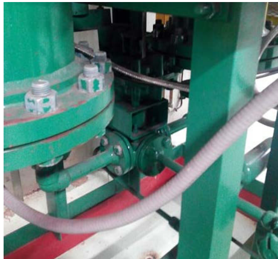
Ilustración 12: Válvula inferior de 4 vías
