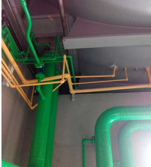
Ilustración 13: Conductos de transporte de hidrógeno en el generador.
