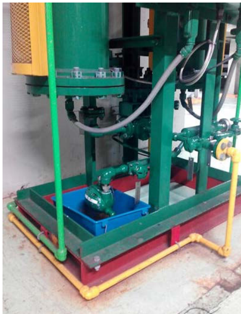
Ilustración 16: Recogida de condensados
