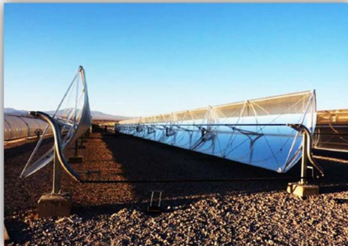
Ilustración 23: Planta de tecnología cilindro parabólica en el desierto de Atacama, Chile. Fuente: ABENGOA SOLAR.
