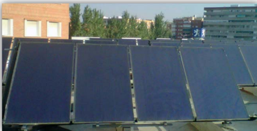
Ilustración 18: Campo colectores térmicos planos sobre cubierta plana. Fuente: SALVADOR ESCODA.
