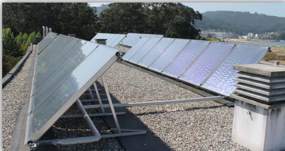
Ilustración 73: Detalle de paneles solares térmicos en cubierta. Edificio en Viveiro Fuente: Elaboración propia.
