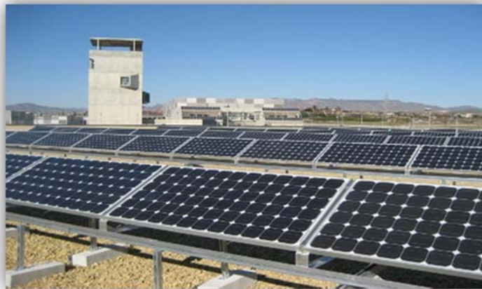
Ilustración 21: Instalación fotovoltaica 48,4 kW. Fuente: INABENSA.
