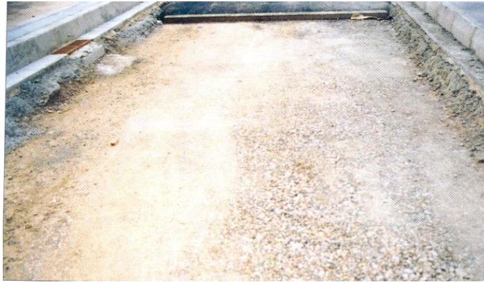
Zahorra con excesiva segregación
