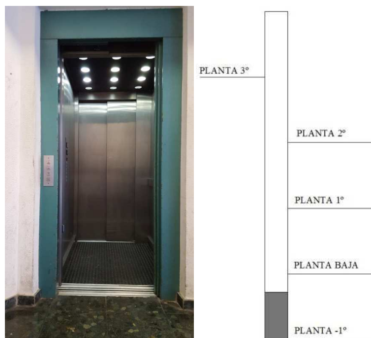
21. Estado actual de ascensor principal. Fuente: Autor.
