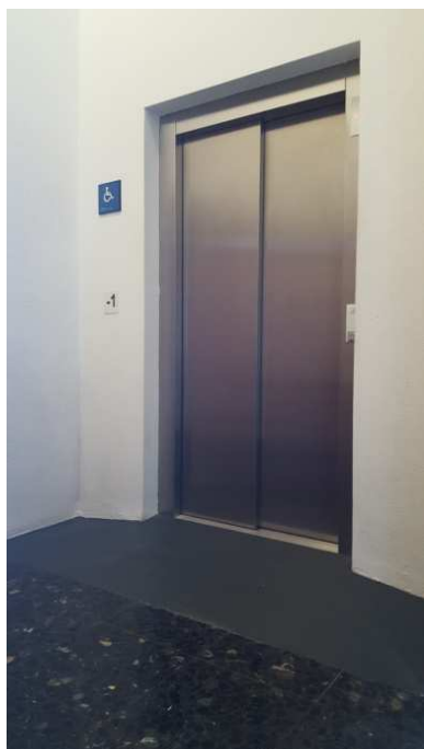
10. Puertas de cabina ascensor secundario. Fuente: Autor.
