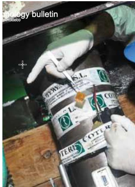
Figura 5.2 - Instalación galga detectora de la torsión del eje de cola.
