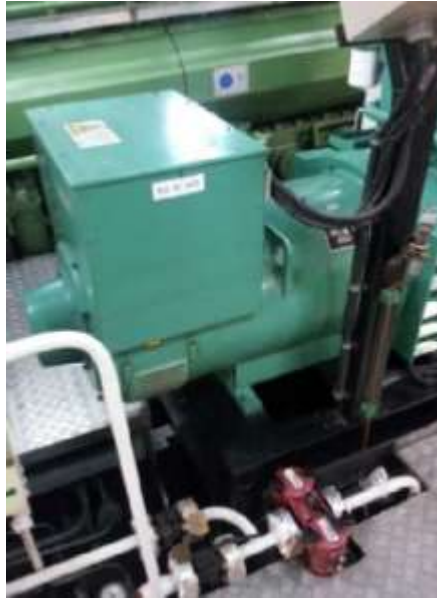
Ilustración 38 Alternador Motor Auxiliar D9 (P.A)
