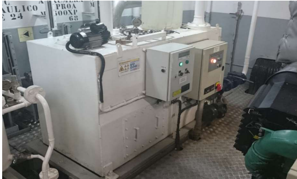
Ilustración 46 Planta de tratamiento de Aguas Negras (P.A)
