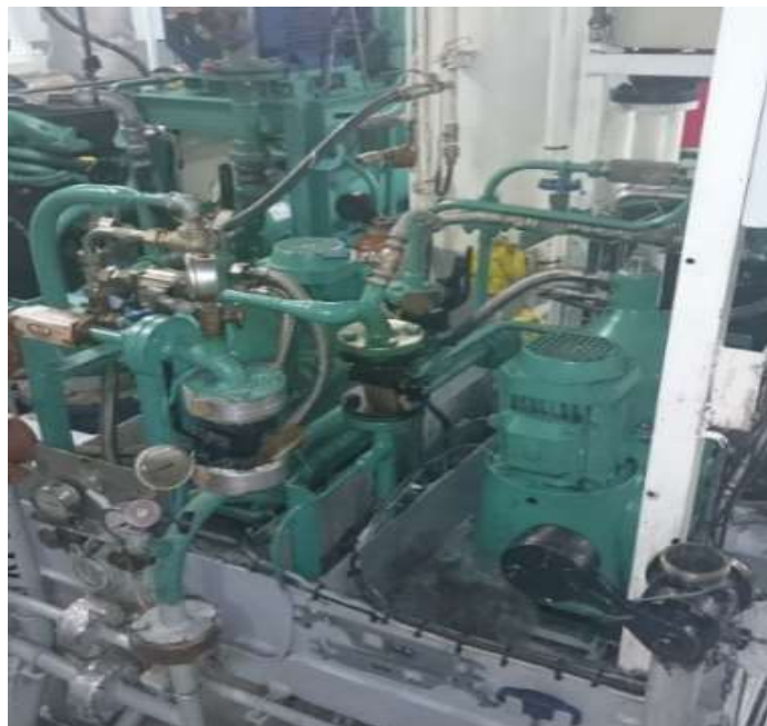
Ilustración 44 Depuradoras de aceite y gas oil (P.A)
