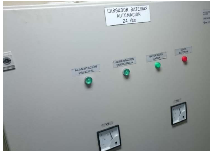
Ilustración 41 Cargador de Baterías (P.A)
