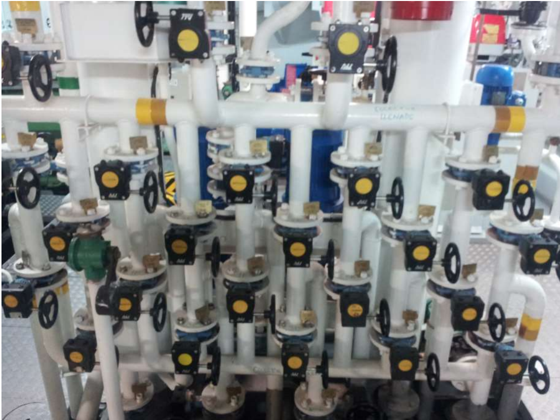
Ilustración 43 Válvulas de Trasiego (P.A)
