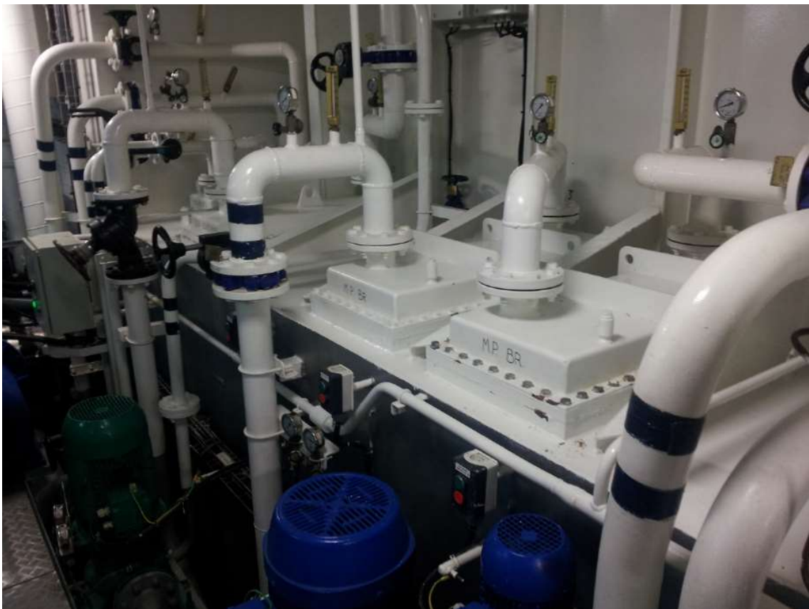
Ilustración 42 Box Cooler (P.A)
