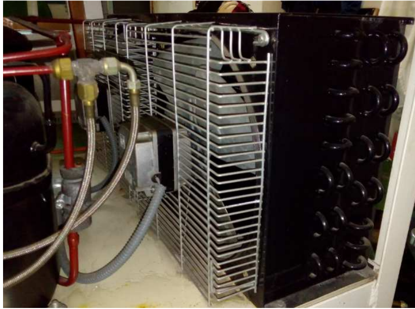
Figura 6.3.1 – unidad condensadora, instalación de estudio.
