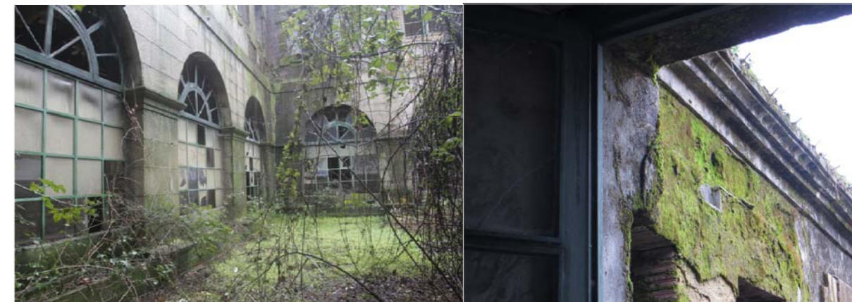
04. corrosión de viguetas metálicas
