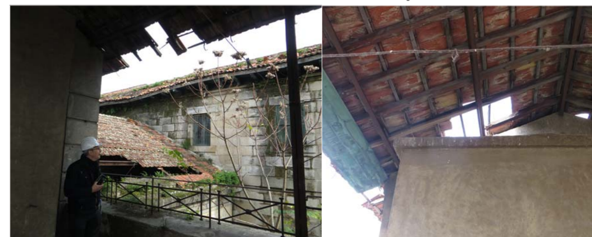
06. Deterioro de las cubiertas, estructura y cerramiento.
