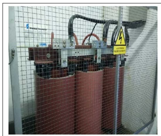
Ilustración 107: Centro de transformación
