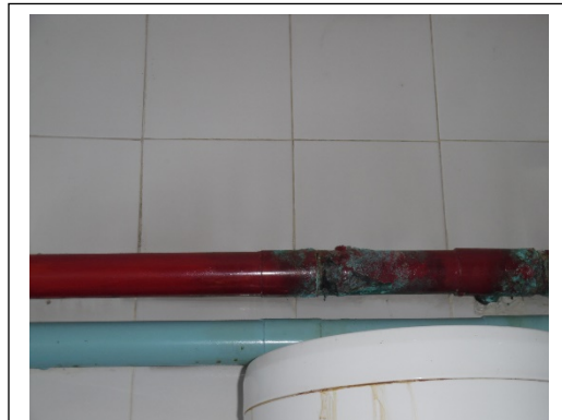
Ilustración 33: Corrosión en tubería de suministro ACS
