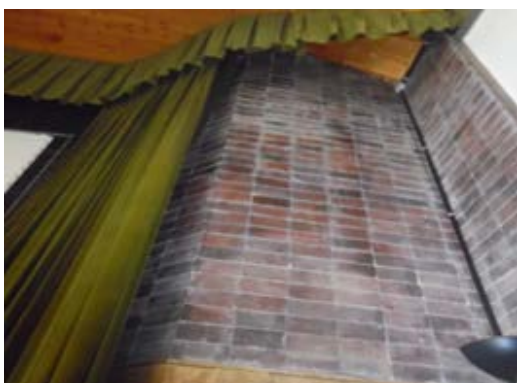
Ilustración 57: Filtraciones de fachada
