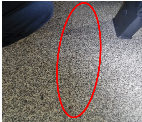
Ilustración 88: Grietas en solado
