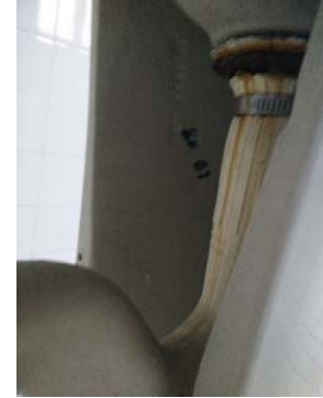
Ilustración 69: Desagüe mal ejecutado
