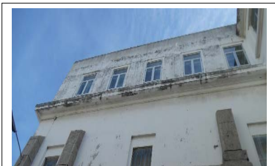
Ilustración 159: Filtraciones de cubierta
