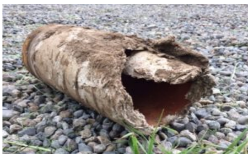
Ilustración 37: Tubería con amianto, fuente: www.elindagador.cl/
