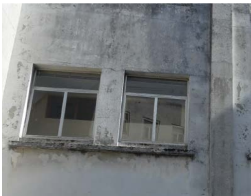
Ilustración 59: Estado degradado de fachada
