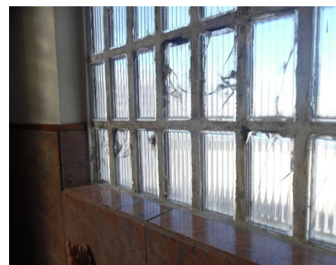
Ilustración 47: Vidrio rotos en escaleras
