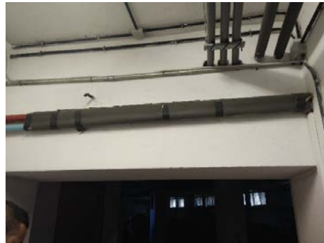
Ilustración 138: Disposición incorrecta de aislamiento
