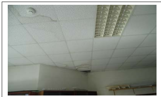
Ilustración 158: Daños por filtraciones de cubierta
