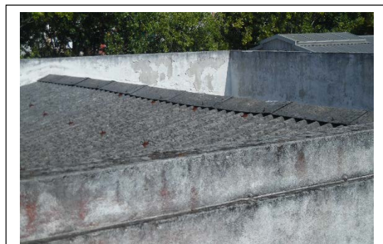
Ilustración 157: Estado de planchas y anclajes oxidados
