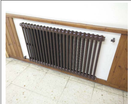
Ilustración 126: Radiador no conectado a la instalación.
