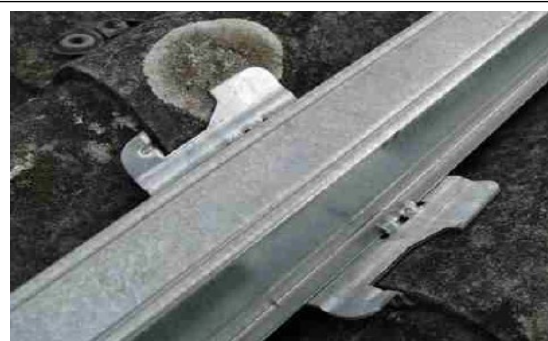
Ilustración 162: Anclaje de soporte a plancha con amianto, fuente: http://www.onduline.es
