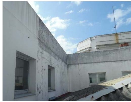
Ilustración 60: Estado degradado de fachada
