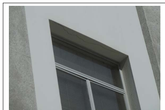
Ilustración 53: Grietas en perímetro de ventana
