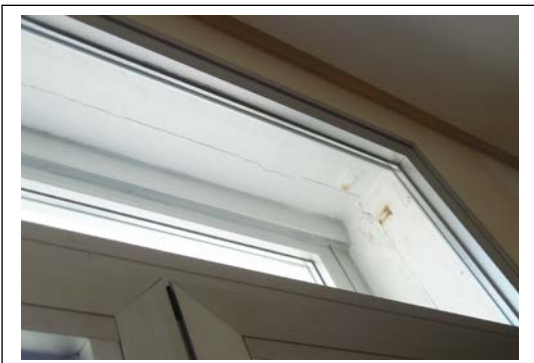
Ilustración 54: Grietas entre ventanas
