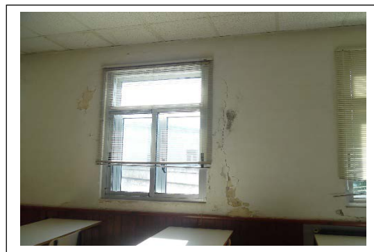
Ilustración 55: Grietas en perímetro de ventana
