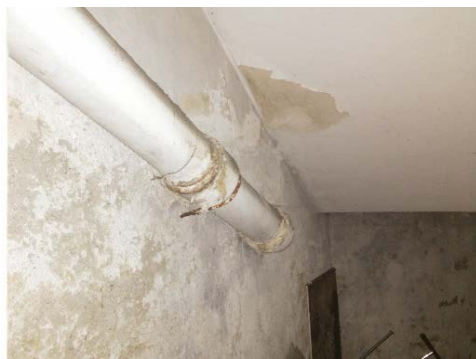
Ilustración 30: Tubería fibrocemento en mal estado
