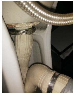
Ilustración 70: Desagüe mal ejecutado
