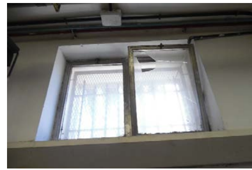
Ilustración 28: Vidrio roto en ventana de sótano
