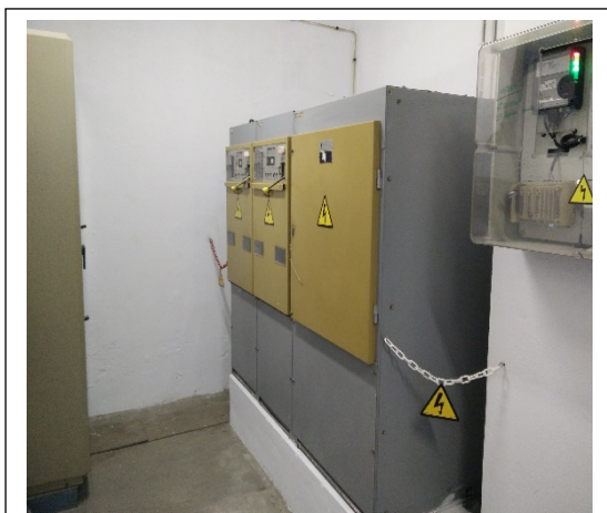
Ilustración 106: Centro de transformación
