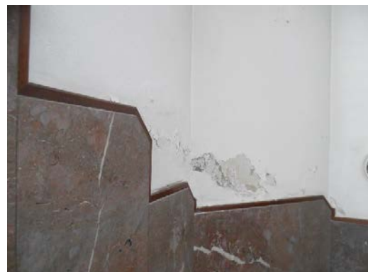
Ilustración 58: Filtraciones de fachada
