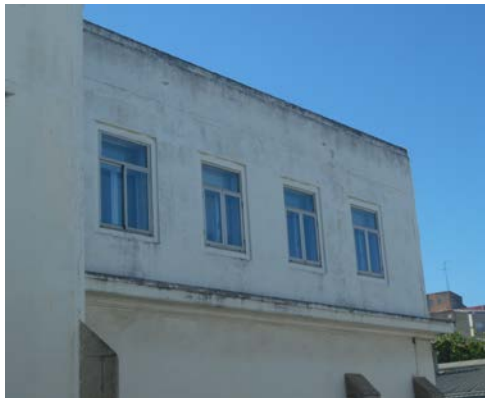
Ilustración 79: Grietas horizontales en cerramiento exterior
