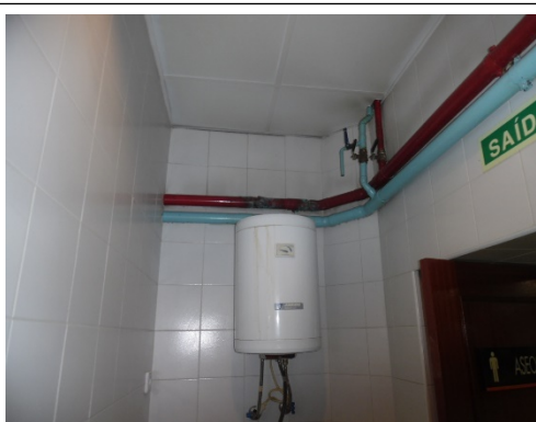
Ilustración 32: Tuberías suministro ACS
