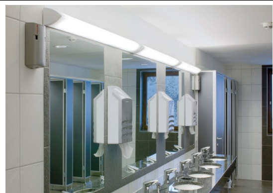
Ilustración 171: Iluminación LED en baños, fuente: www.trilux.com
