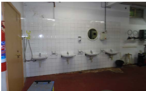
Ilustración 25: Daños por escape de agua
