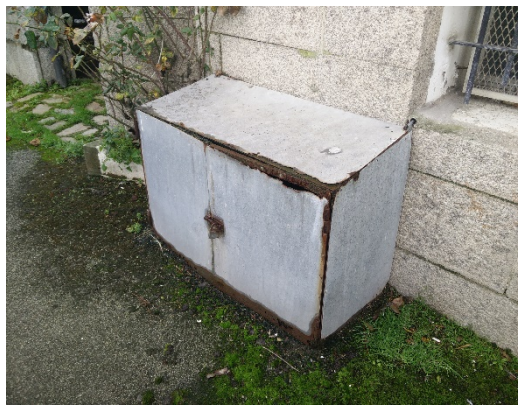
Ilustración 104: Recinto donde se albergan las bombonas de butano
