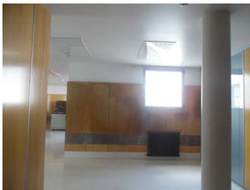
Ilustración 52: Daños por filtraciones
