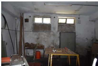
Ilustración 15: Daños por filtraciones de lluvia
