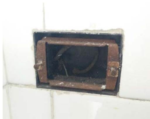
Ilustración 113: Partes de la antigua instalación eléctrica
