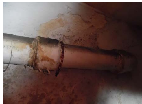
Ilustración 29: Tubería fibrocemento en mal estado
