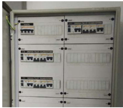
Ilustración 110: Cuadro eléctrico parte de la instalación
