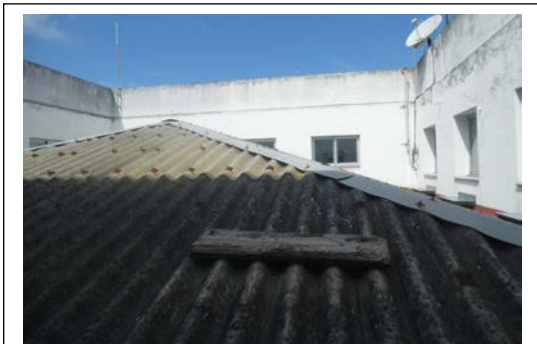
Ilustración 156: Estado de cubierta y tablón para operaciones de reparación
