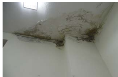
Ilustración 14: Daños por filtraciones de lluvia
