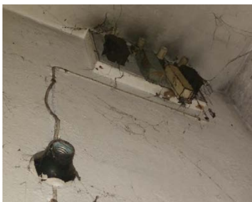
Ilustración 112: Partes de la antigua instalación eléctrica
