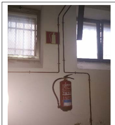
Ilustración 121: Extintor y señalización en sótano
