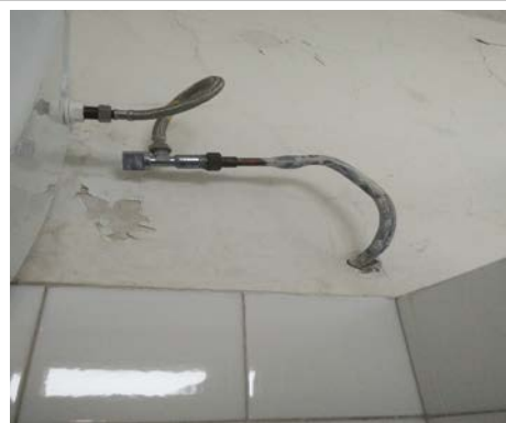
Ilustración 133: Tubería de suministro de agua de plomo
