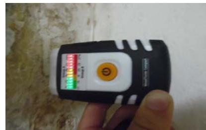
Ilustración 17: Mediciones de humedad en paramentos
