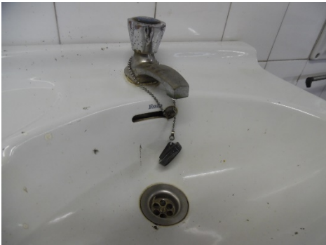
Ilustración 137: Grifo con pérdida de agua
