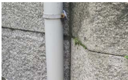
Ilustración 128: Elementos metálicos oxidados
