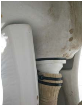
Ilustración 71: Desagüe mal ejecutado
